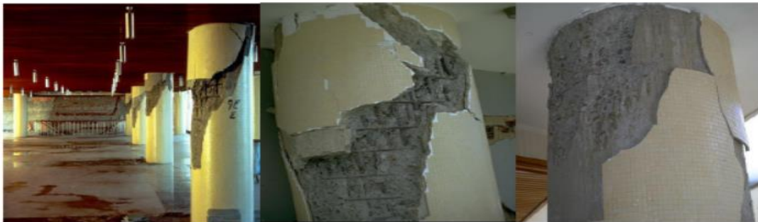
Figura 30. Daños en las columnas del piso crítico del Hotel Macuto Sheraton (NISEE, 2021).
