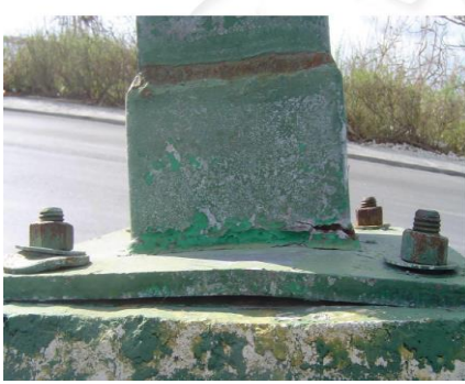
a) Daño Moderado Deformación de placa base y agrietamiento de soldadura. (CENAPRED, 2014)
