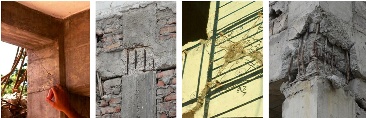
Figura 14. Daños en juntas (nodos) de concreto armado.
