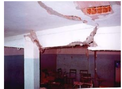
5. Daño Completo Escuela Valentín Valiente, Cariaco 1997, (Foto G. Malavé)
