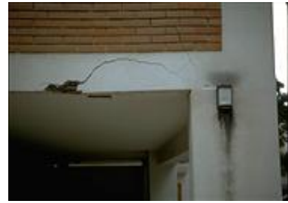
2. Daño Moderado Caracas 1967, (NISEE, 2021)
