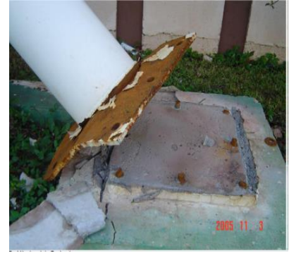
c) Daño Completo Rotura en pernos de la placa base. (CENAPRED, 2014)
