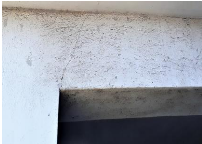
1. Daño Menor Sismo de Yaguaraparo 2018 (Foto A. Urich)
