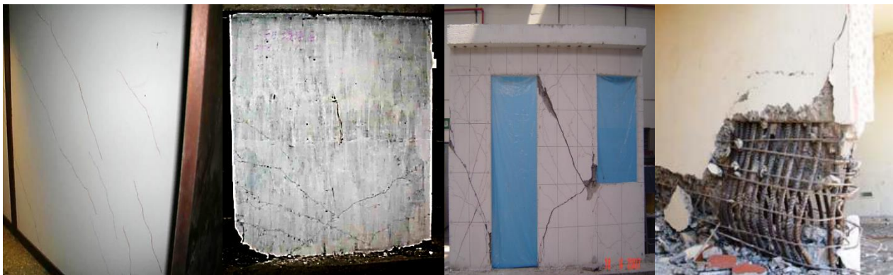
Figura 17. Ejemplos de daños en muros de concreto armado.
